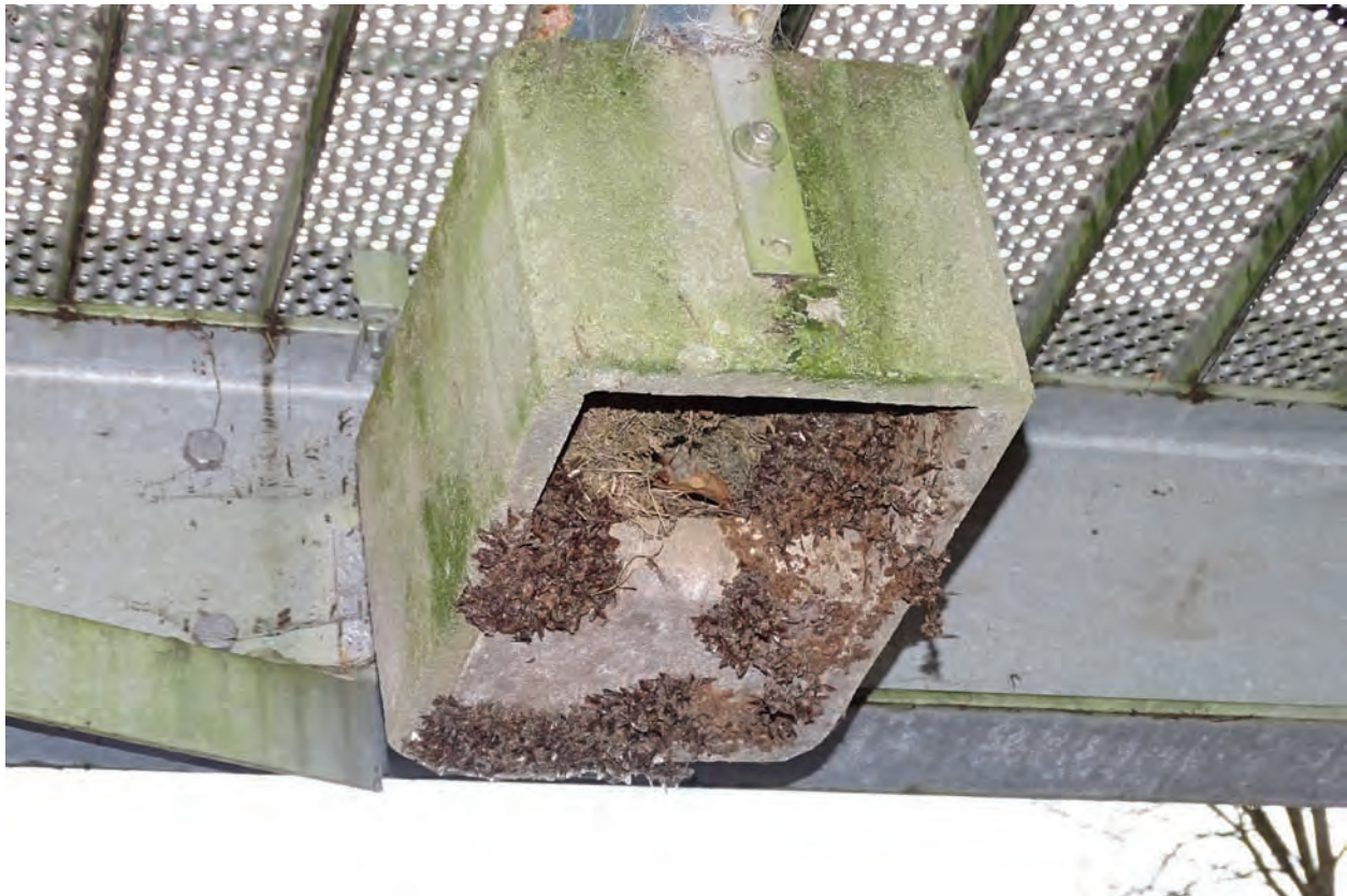
Abb. 1: Mit Ibisfliegen behaftete Unterseite des Betonkastens mit Einfluglücke. © Rainer Mönig
